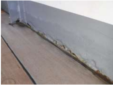
著しい腐食が見られたフード側壁基部
